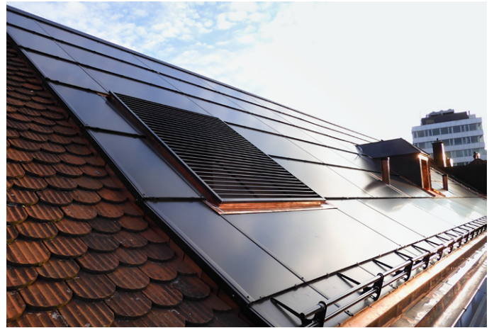
Die Wogeno leistet auch Pionierarbeit, zum Beispiel mit dem Pilotprojekt ECO-Haus an der Denzlerstrasse 36 mit Luftwärmepumpe und Solarpanels.
