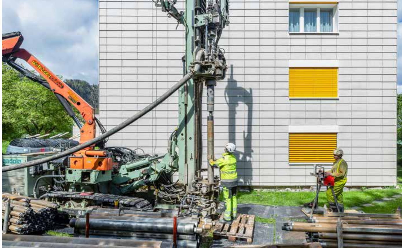
In der Siedlung Wacht in Adliswil (ZH) hat die Allgemeine Baugenossenschaft Zürich eine Wärmepumpe eingebaut. Sie ersetzt die alte Gasheizung.
